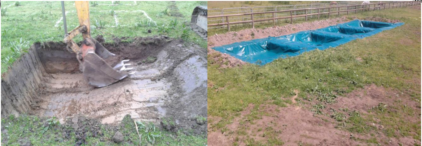
Fig.2: Fasi della realizzazione delle vasche per i riproduttori e per i giovani.
